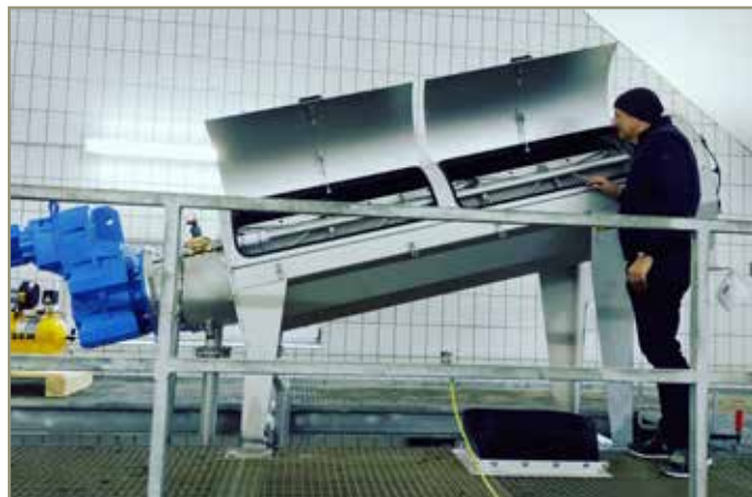
Neue Schlammpresse in der Kläranlage
